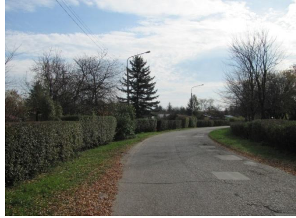
Zdjęcie 19. Przykład zdegradowanej nawierzchni ulicy wewnątrz obszaru
