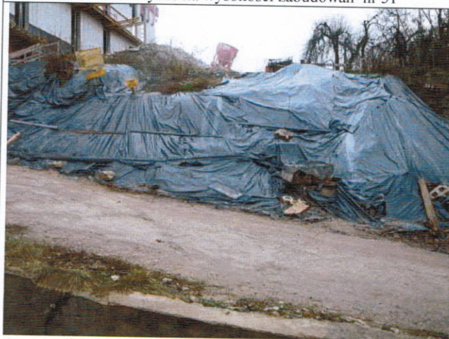
Osunięcia gruntów na działce nr 83/1
