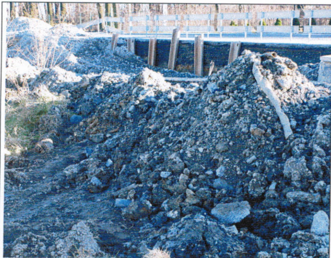
zniszczona droga ze skarpą główną z nasypami (XI/20101)
