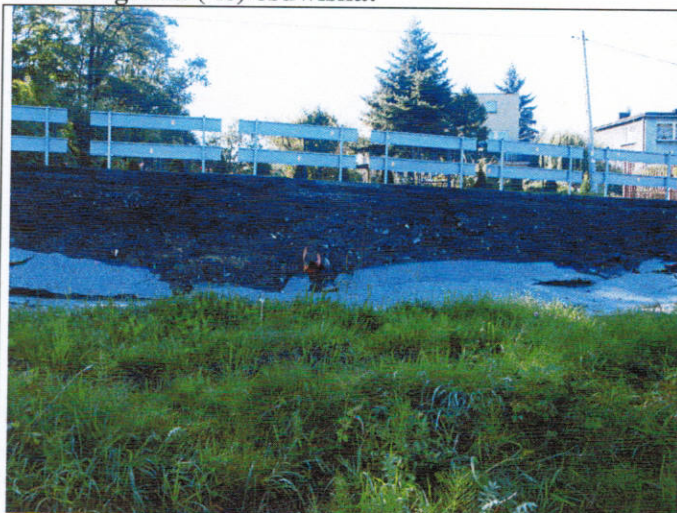
Skarpa główna osuwiska wraz ze zniszczonym fragmentem drogi
