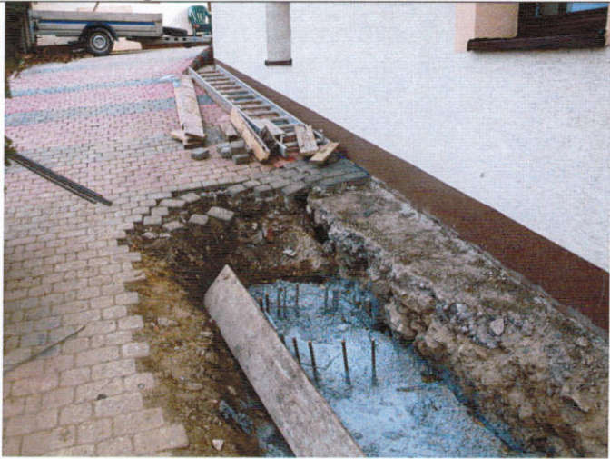
Speknięcia i szczeliny wzdłuż budynku nr 17
