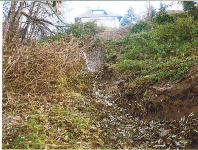
Swieża skarpa na terenie osuwiska „a”
