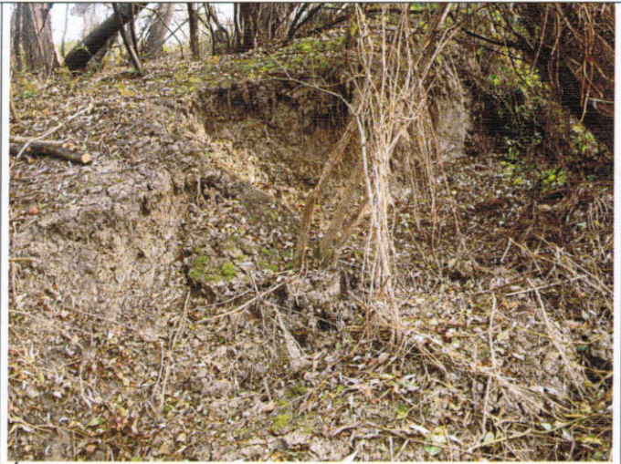
Swieża skarpa na terenie osuwiska „a”
