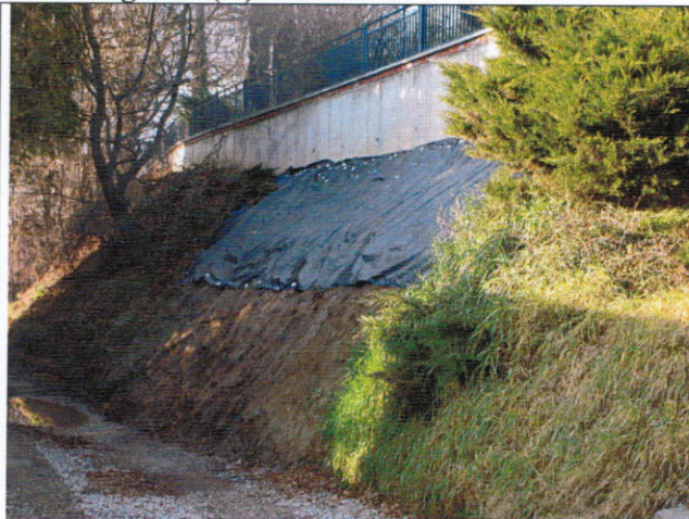
Zerwanie gruntu pod ogrodzeniem posesji Kamedulska nr 21 bezpośrednio na ulicą
