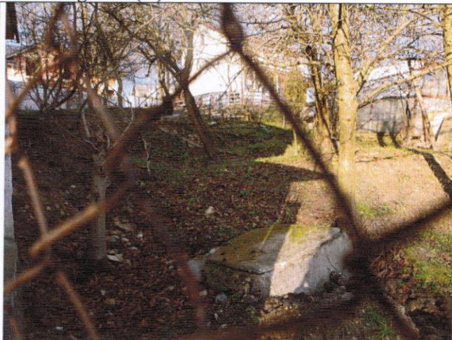
Oberwanie gruntów na działce nr 342/2 na wysokości zabudowań gospodarczych na działce nr 343/1 ul. Kaszubska nr 6
