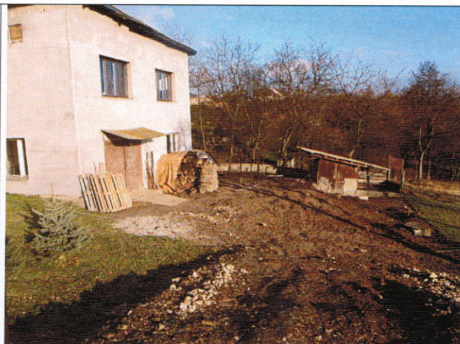
Widok na skarpe osuwiska pod budynkiem gospodarczym ul. Kaszubska nr 6, częściowo wyrównane i odwodnione.
