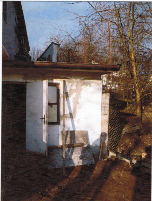
Widok na spękane ściany przybudówki do budynku gospodarczego ul. Kaszubska nr 6.
