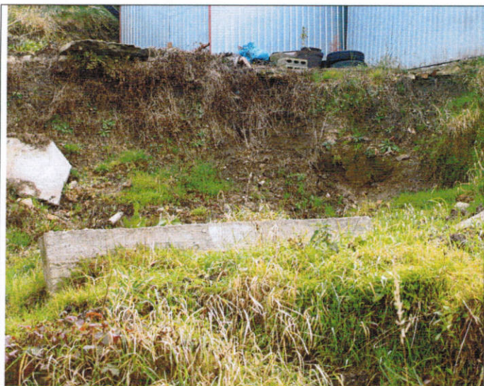
Skarpa główna osuwiska
