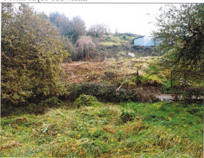
Czoło osuwiska, w górze skarpa główna osuwiska
