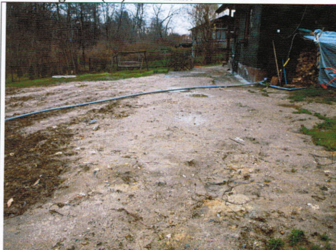
Miejsce „zasypanego” osuwiska obok budynku mieszkalnego Żabia 1.
