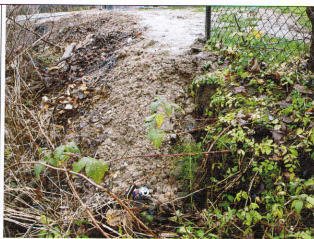
Fragment zachowanej skarpy głównej i uszkodzone ogrodzenie
