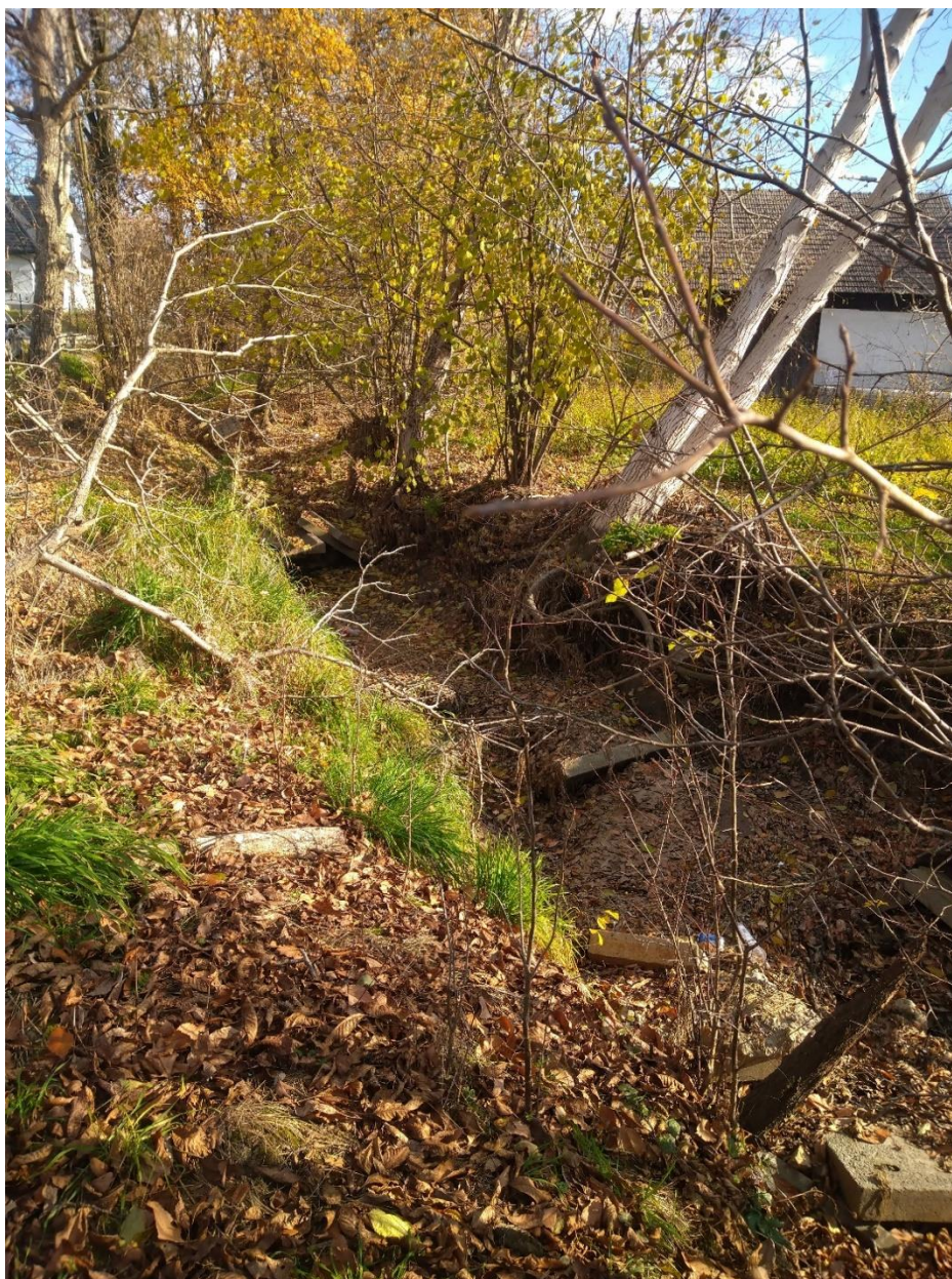
Fot. 10 Zniszczenie w obrębie rowu odwadniającego płynącego od strony Kocmyrzowa
