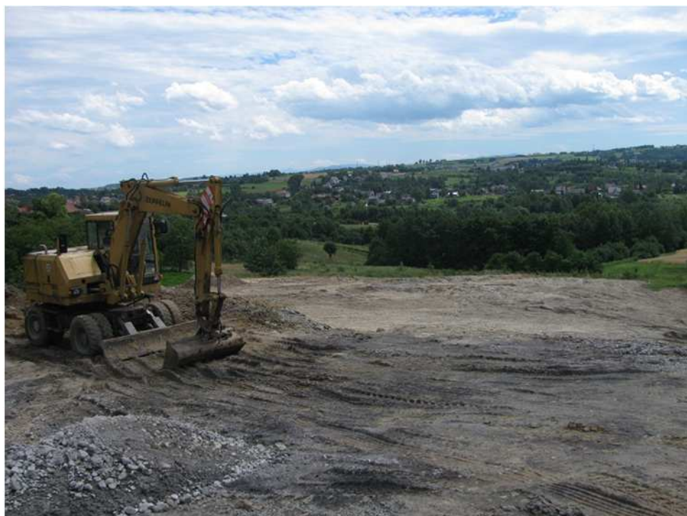
Fot.2.15. Zdjęcie zrobione z terenu budowy (nasyp budowlany), poniżej stoki osuwiskowe, Soboniowice (fot. J. Kowalczuk).
