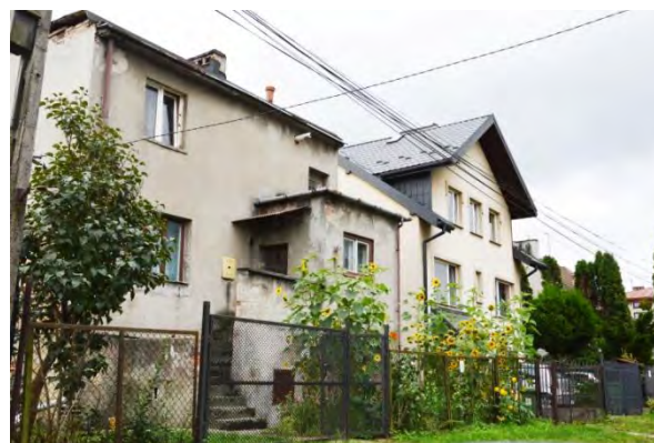
Fot. 20 Budynek mieszkalny z zaniedbaną elewacją.
