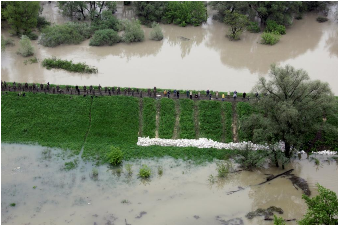
Fot. 10 Akcja zabezpieczenia wału przy u. Wioślarskiej
