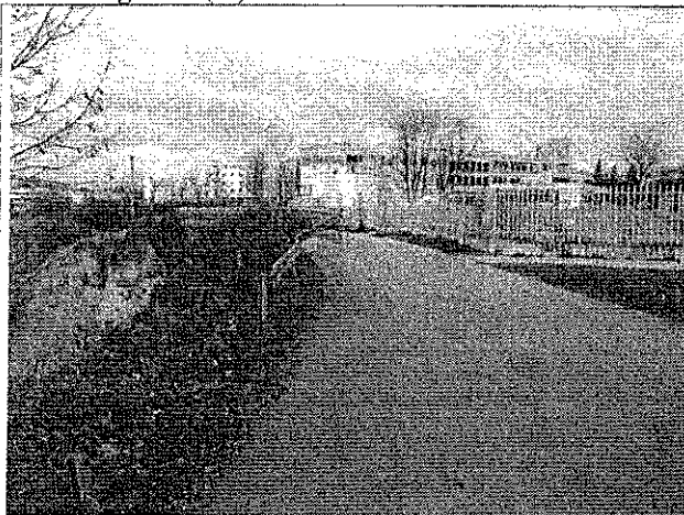
Widok na skarpy osunięcia oraz zniszczenie ścieżki spacerowej
