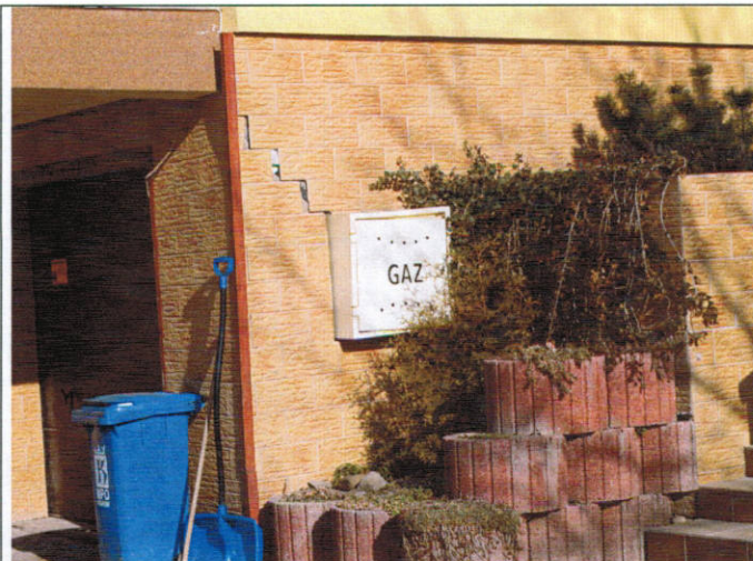
Spękania budynku 12g
