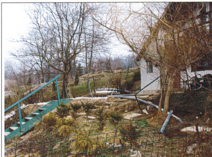
Odsunięte schody wejściowe od budynku
