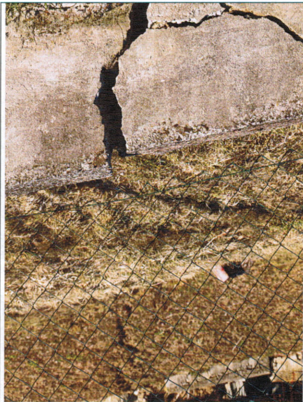
Spękane murki w ogrodzeniu
