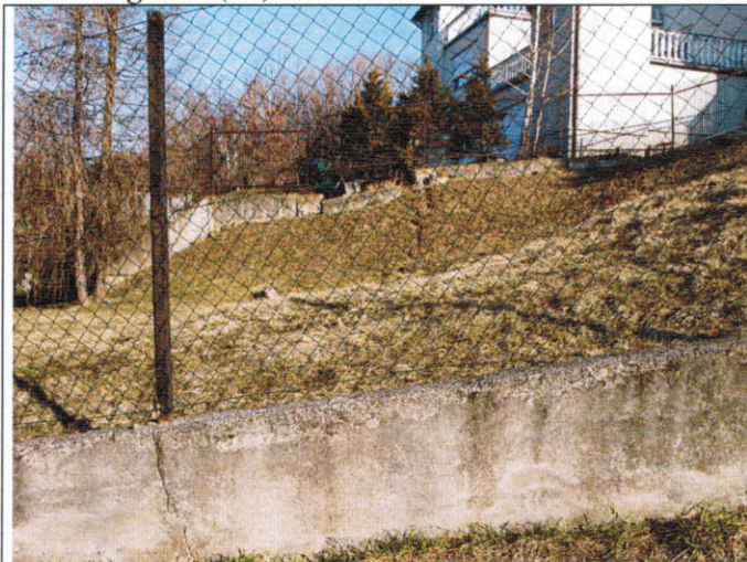
Szczelina przebiegająca przez działkę 115
