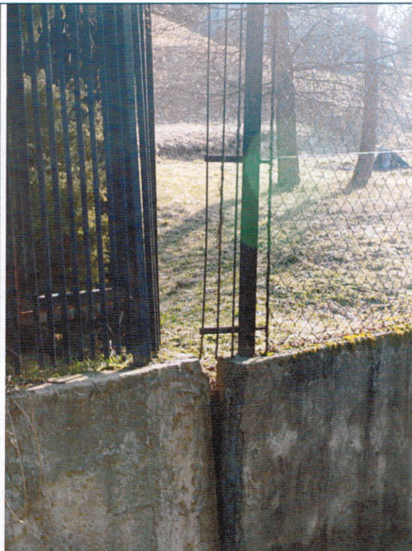
Przemieszczone ogrodzenie przez osuwisko
