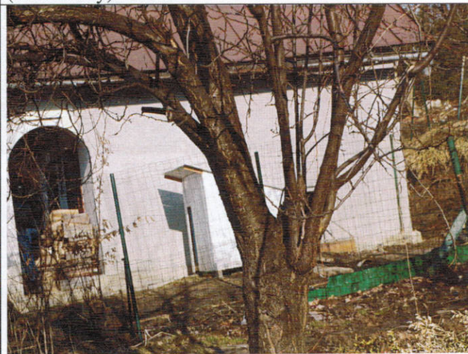
zniszczony i przemieszczony budynek mieszkalny
