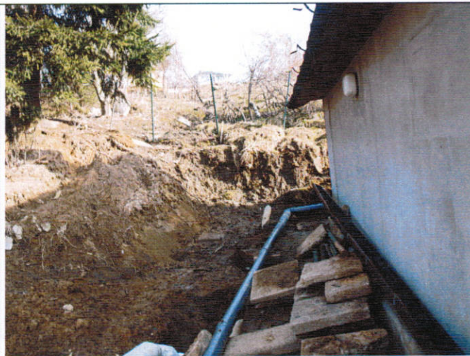
Odwodnienie koło budynku uszkodzone przez osuwisko
