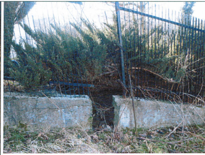
Uszkodzone ogrodzenie przez osuwisko
